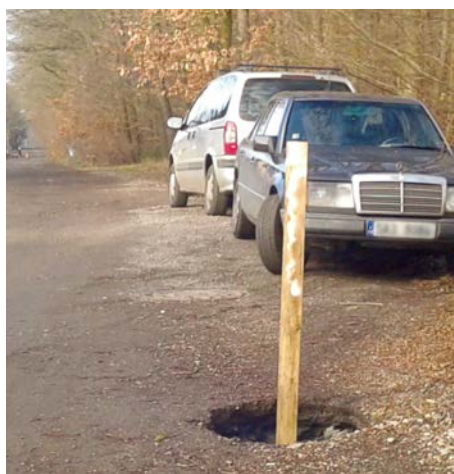
Propadlá vozovka i přes upozornění zůstala radnicí asi měsíc bez povšimnutí.
